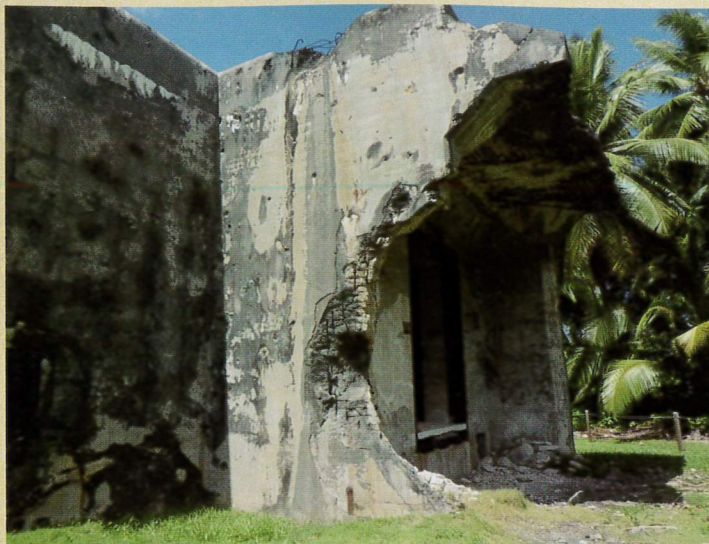
P5写真②と同じ弾薬庫。頑丈な鉄筋コンクリートは50cmほどの厚みがあり、猛爆撃に耐えた。ルオットはクエゼリン本島よりも遺構が多く残っている。
