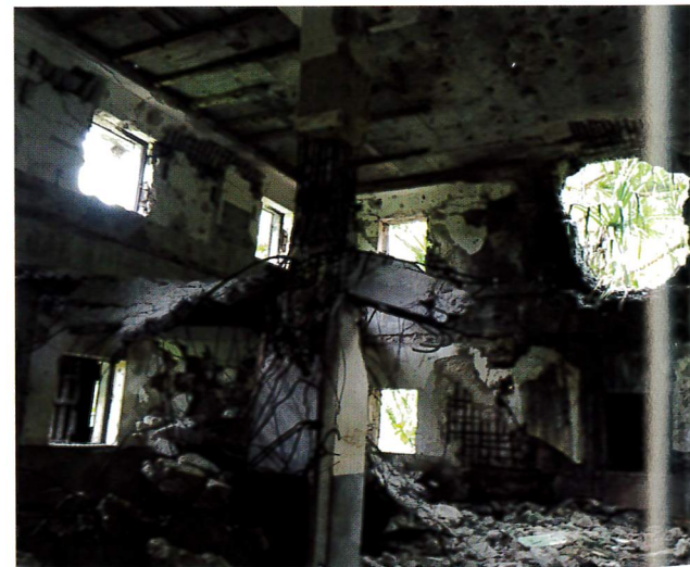
窓から飛び込んだ爆弾が炸裂し、ここで多くの将兵が犠牲になった。中はコンクリート片が散乱したままで、時間が止まっているような静寂さだった。コンクリート片の下に遺骨を探したが今回は発見できなかった。
