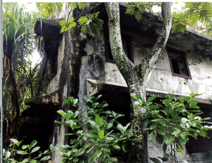
ジャングルの中を分け入り、発見した2階建ての八〇二空本部通信所跡。爆撃を受け、中は崩壊している。ウォッセには日本海軍の建物、トーチカ、弾薬庫など、多くの戦跡遺構が、手付かずのまま残っている。
